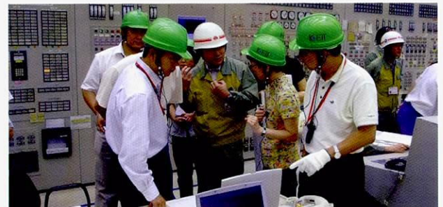
在中部电力(株)四日市火力发电所的控制室
