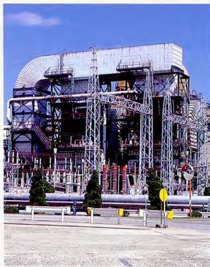
三菱油化四日市事業所の排煙脱硫装置
