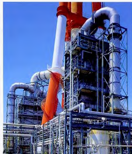
排煙脱硫装置
