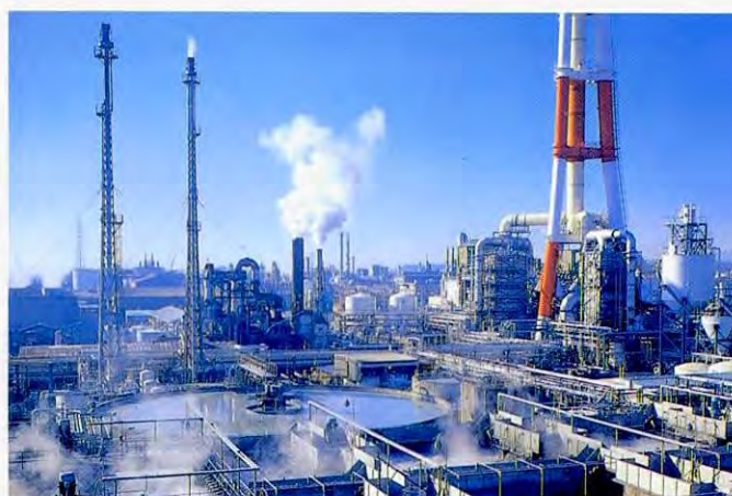
活性汚泥処理装置
