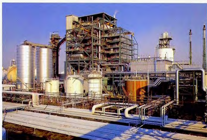
脱硝装置とバグフィルター
