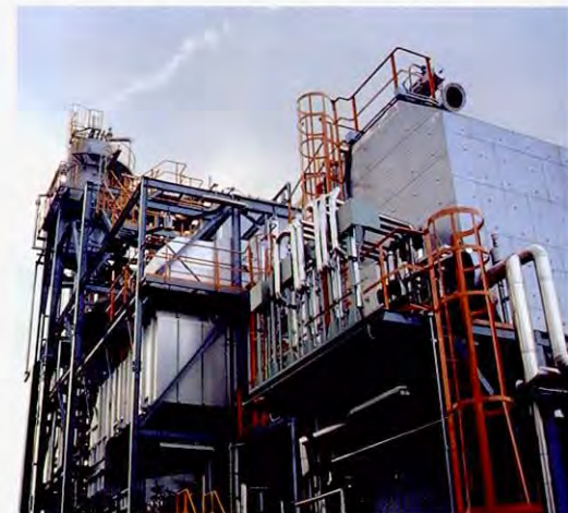
コージェネレーション設備
