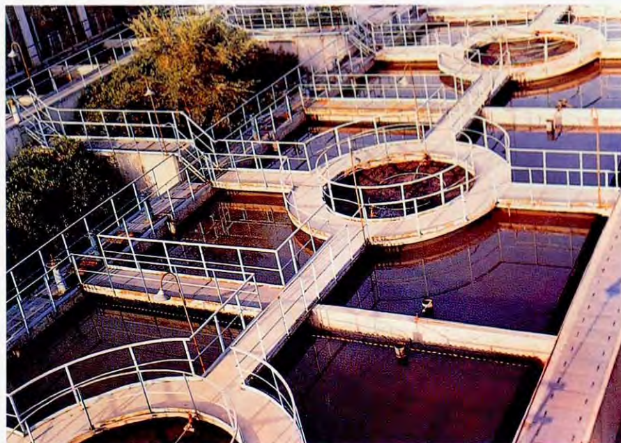
石油化学工場の排水処理施設（洛陽市）
