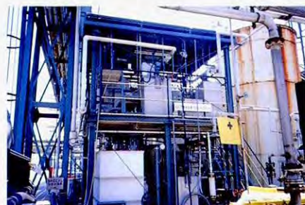
排水処理実験用ミニプラント
